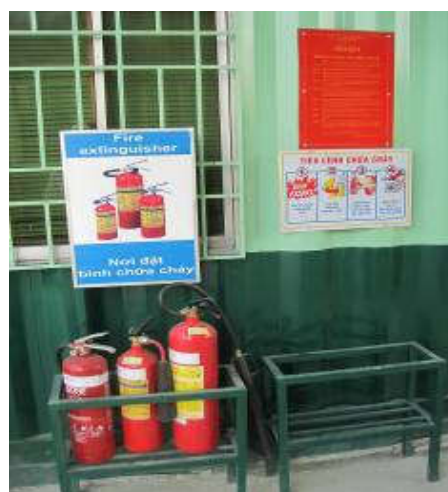
TRANG BỊ BÌNH CHỮA CHÁY
