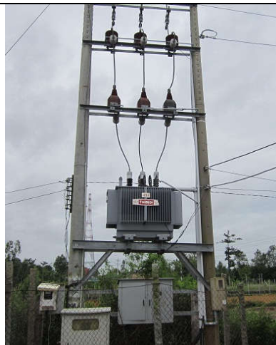
Trạm biến áp giàn
