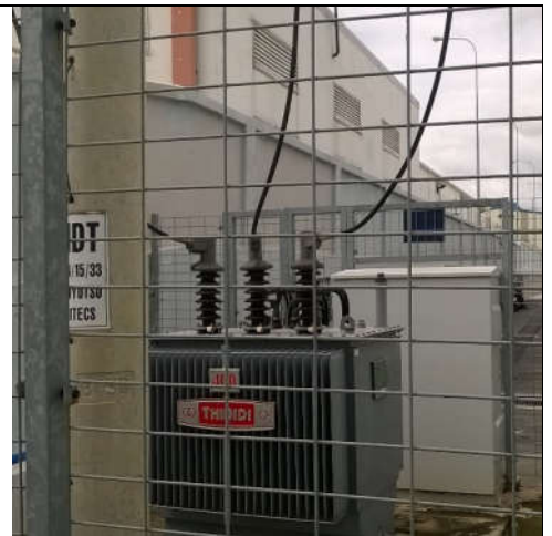
Trạm biến áp nền
