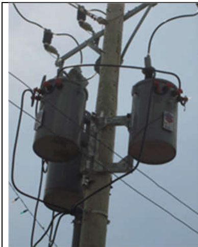
Trạm biến áp treo
